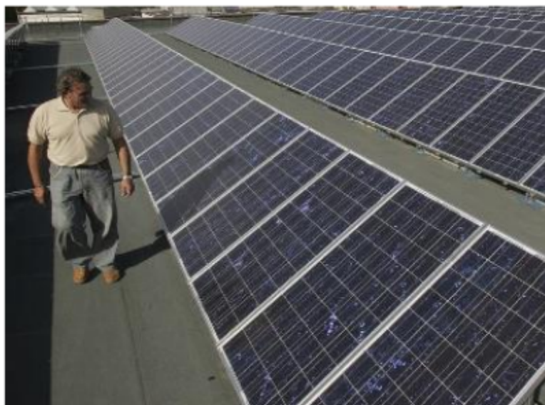
Pannelli fotovoltaici e, in alto, la lettura dei contatori
